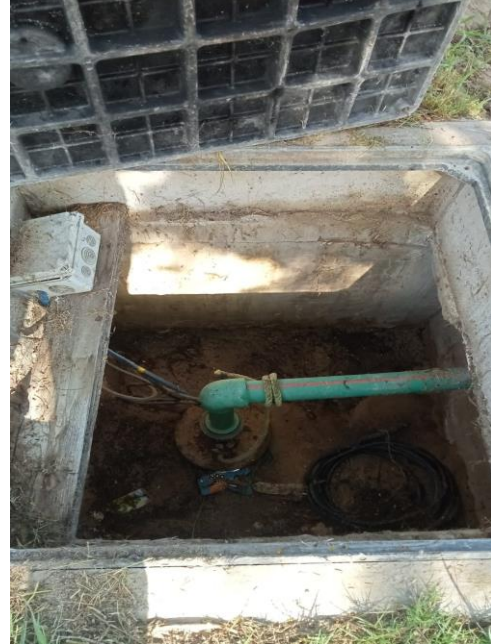
إحدى غرف تفتيش أعلى قيسون به طلمبة أعماق لنزح المياه الجوفية واستخدامها في ري الملاعب وأحواض الزراعات
